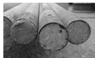
コンクリート詰り
